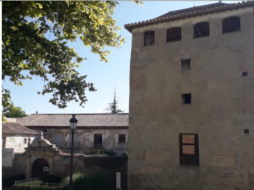
Imagen 4. El Palacio de los Enríquez y el Monasterio de San Jerónimo en un avanzado estado de deterioro (@Archivo personal)
