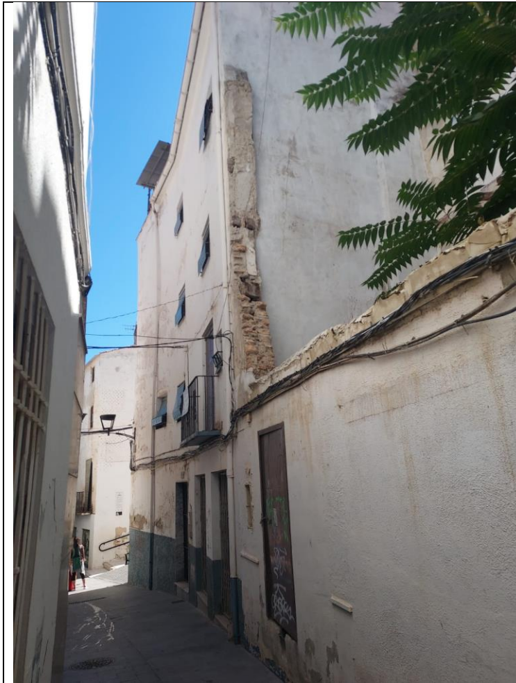
Imagen 6. Edificio deteriorado que rompe la estética del casco antiguo del municipio de Baza (©Archivo personal)
