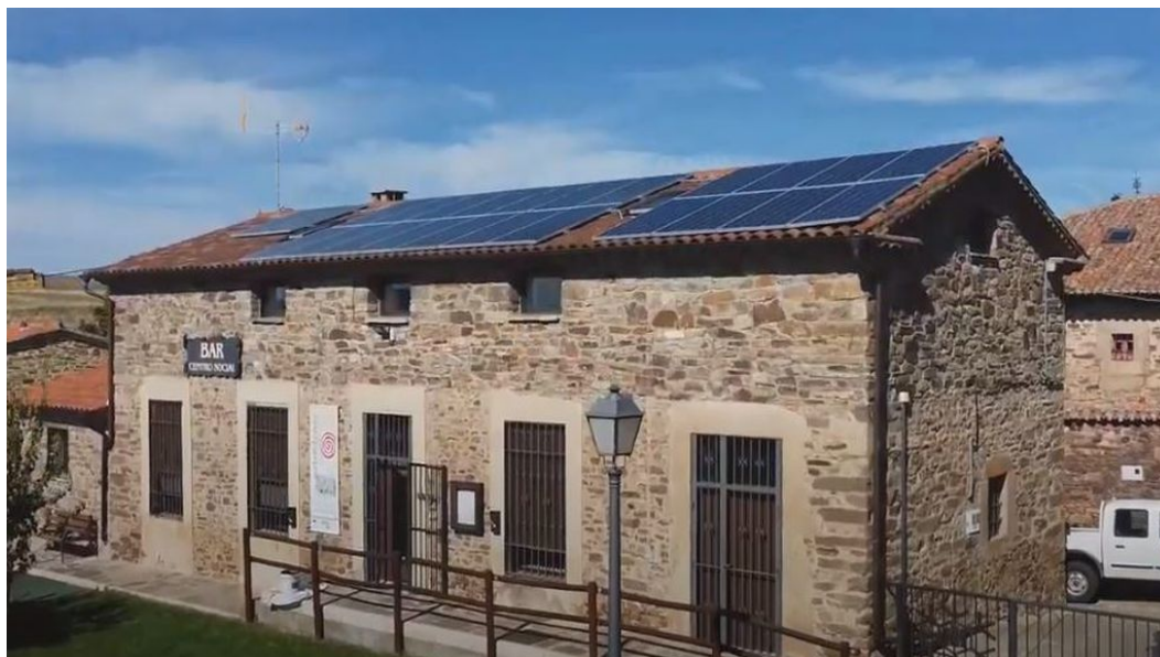
Vista de la instalación solar y punto de suministro del centro social de Castilfrío de la Sierra.
