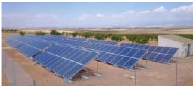
Instalación de autoconsumo para bombeo existente en Galera.
