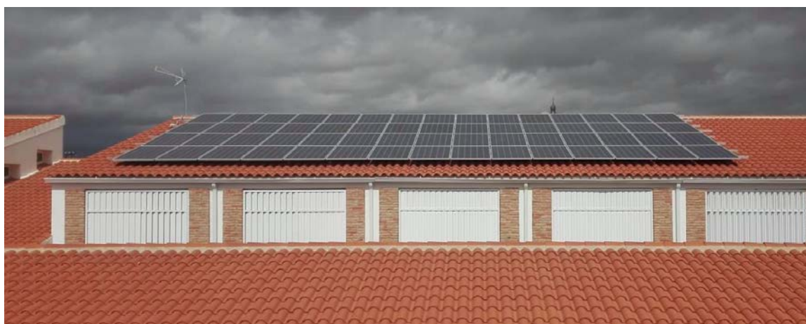
Instalación de autoconsumo y ACS en el edificio del CEIP Los Ríos de Castellár
