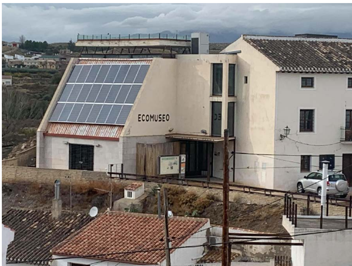
Instalación de autoconsumo en el edificio del Ecomuseo de Castellár.
